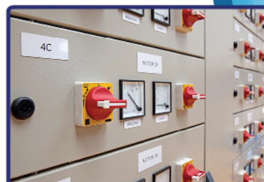
Centro de Controle de Motores
