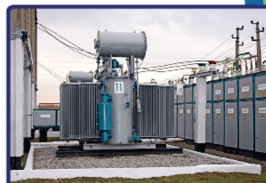
Engenharia Eléctrica (Baixa e Média Tensão)
